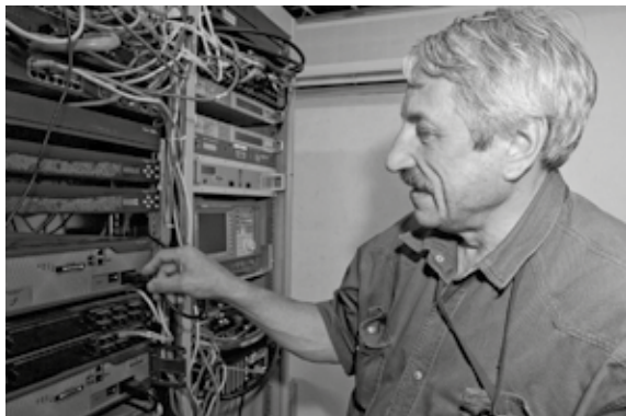
Yuiy Sokolov uit Rusland is een UNV Radio-Ingénieur en beheert het telefoon- en hoge-frequentie-radionetwerk in de UNMIL-basis in Gbarnaga, Liberia.
